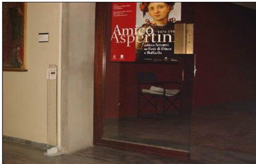
Esempio di installazione presso la Pinacoteca Nazionale – Bologna
